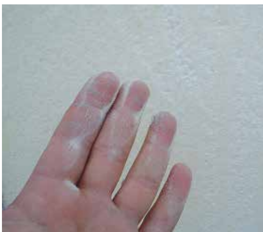
Figura 88 - Deterioração superficial do AIRPOP
