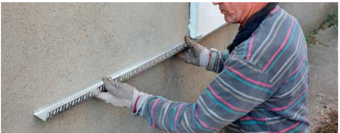
Figura 77 - Colocação do perfil de arranque (cota de segurança para evitar contacto com água do solo)
