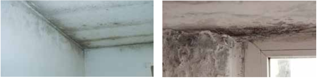
Figura 6 - Tetos e paredes com fungos
