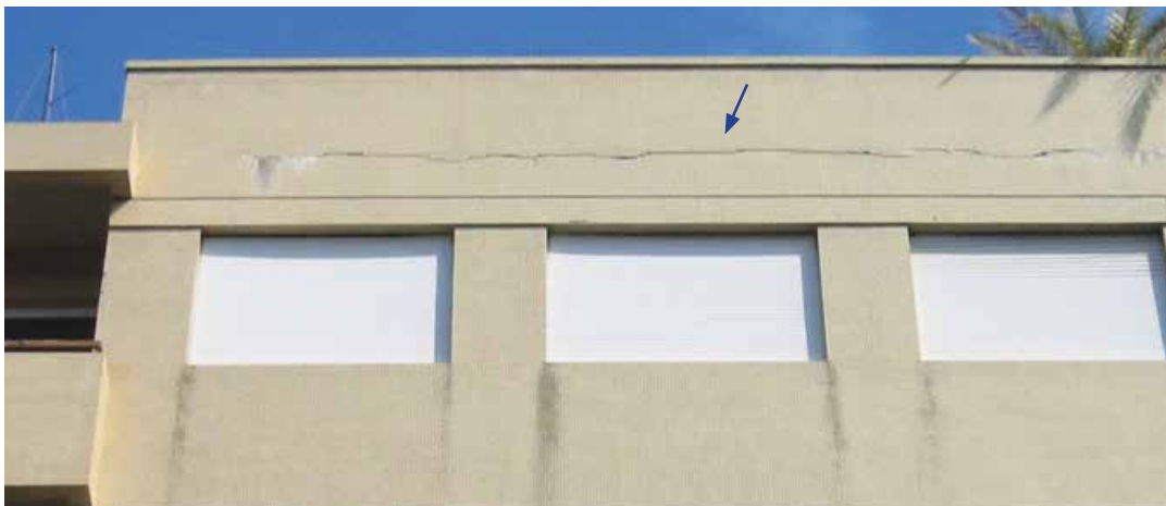
Figura 72 - Fachada com fissuras
