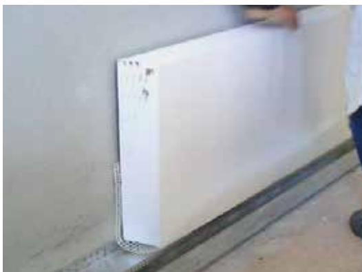
Figura 86 - Primeira fiada de placas com rede de ligação. Evita a fissuração na zona do perfil
